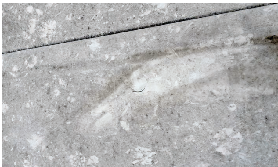
(1) Hagelschaden aufgrund zu geringer Abdichtungsbahnstärke (1,5 mm)
