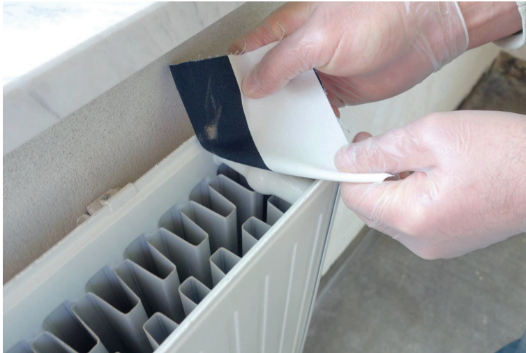
Bild 55: Das Bild zeigt den „Handschuhtest“ mittels eines schwarz-weißem Tuchs, bei dem eventuell noch vorhandene Liegestäube sichtbar gemacht werden sollen. In diesem Beispiel soll ein Heizkörper geprüft werden, der im Rahmen einer Feinreinigung mangelhaft gereinigt wurde. (Quelle: Uwe Münzenberg)
