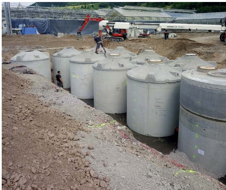
(4) Die Regenspeicher stehen nebeneinander und sind unterirdisch zu einem kommunizierenden Gefäß von ca. 170 m 3 Fassungsvermögen verbunden. Das zulaufende Regenwasser wird in zwei Sedimentationsbehältern gereinigt. Der Dachflächenanteil, der in die Regenspeicher entwässert, beträgt ca. 4.000 m 2 .
