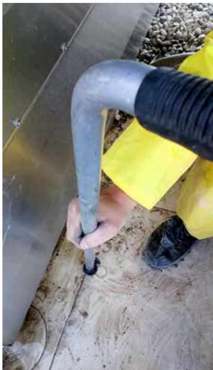
(2) Einleiten des Gasgemisches unter die Flachdachabdichtung
