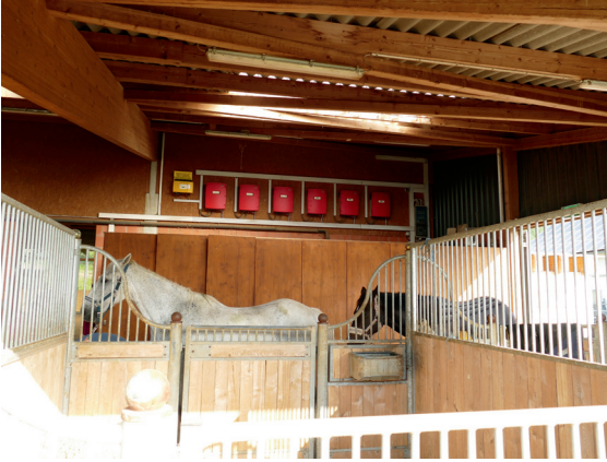
Abb. 3.7-6: Wechselrichter in einem Reitstall (=feuergefährdete Betriebsstätte), noch dazu auf einem Holzgrund installiert, Quelle: SV Schröder
