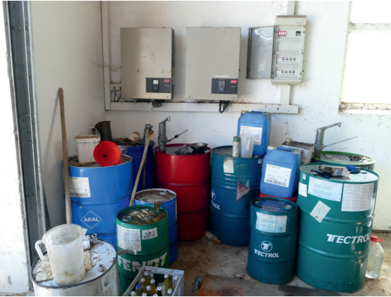
Abb. 3.7-4: Nicht erlaubter Betrieb in Räumen mit gelagerten Schmier- und Betriebsstoffen, Quelle: SV Schröder
