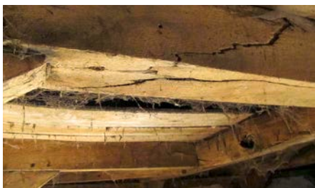
(5) Bruch im Stichgebälk des oberen Stockwerks (Westseite)
