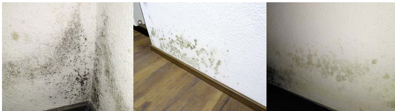
(1) Typische Schadensbilder für Schimmelpilzbefall in Wohnbereichen
