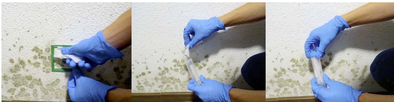
(5) Probenahme einer Wischprobe von einer verschimmelten Wandoberfläche für die anschließende Mykotoxinanalytik
