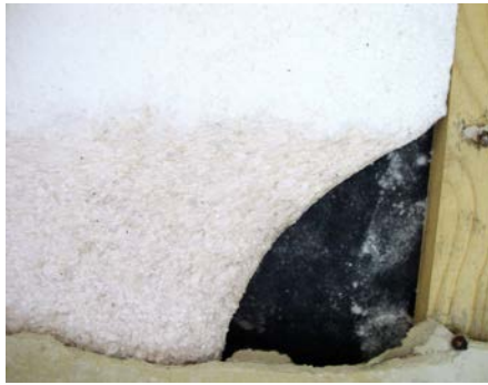
(5) Zerstörung der Polystyrol-Dämmung durch Leichtöl
